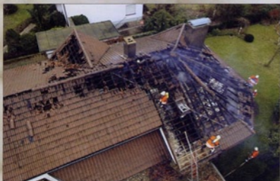
„Feuer Groß“: Aus der Rückseite des freistehenden zweigeschossigen Einfamilienhauses schlugen bei Ankunft der Wehren bereits die Flammen.
